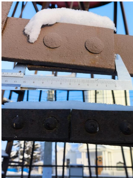
Рисунок 2 – Фрагменты конструкций, пораженные коррозией на башне в Копосове (сверху) и защищенные после реконструкции башни в Ляхове (снизу)
