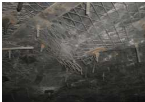
а - деформации в виде прогибов кровли горной выработки
